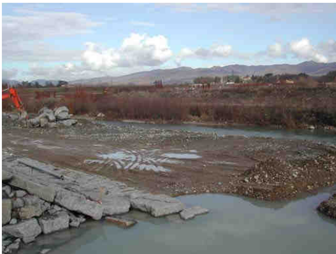
Fig. 10. Realizzazione altamente impattante di difese spondali (foto E. Pini Prato)
