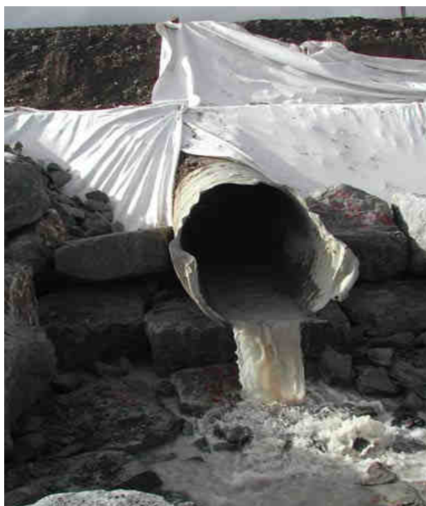
Fig. 19. Scarico di acque di lavaggio betoniere direttamente in fiume (foto E. Pini Prato)
